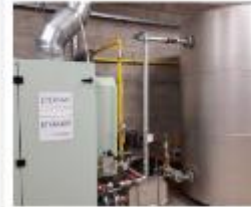
Basilique de Koekelberg Cogénération
