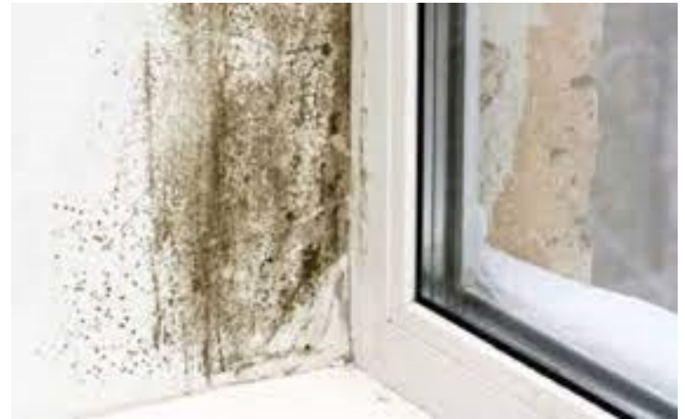
Nieuwe HR dubbele beglazing zonder ventilatierooster
